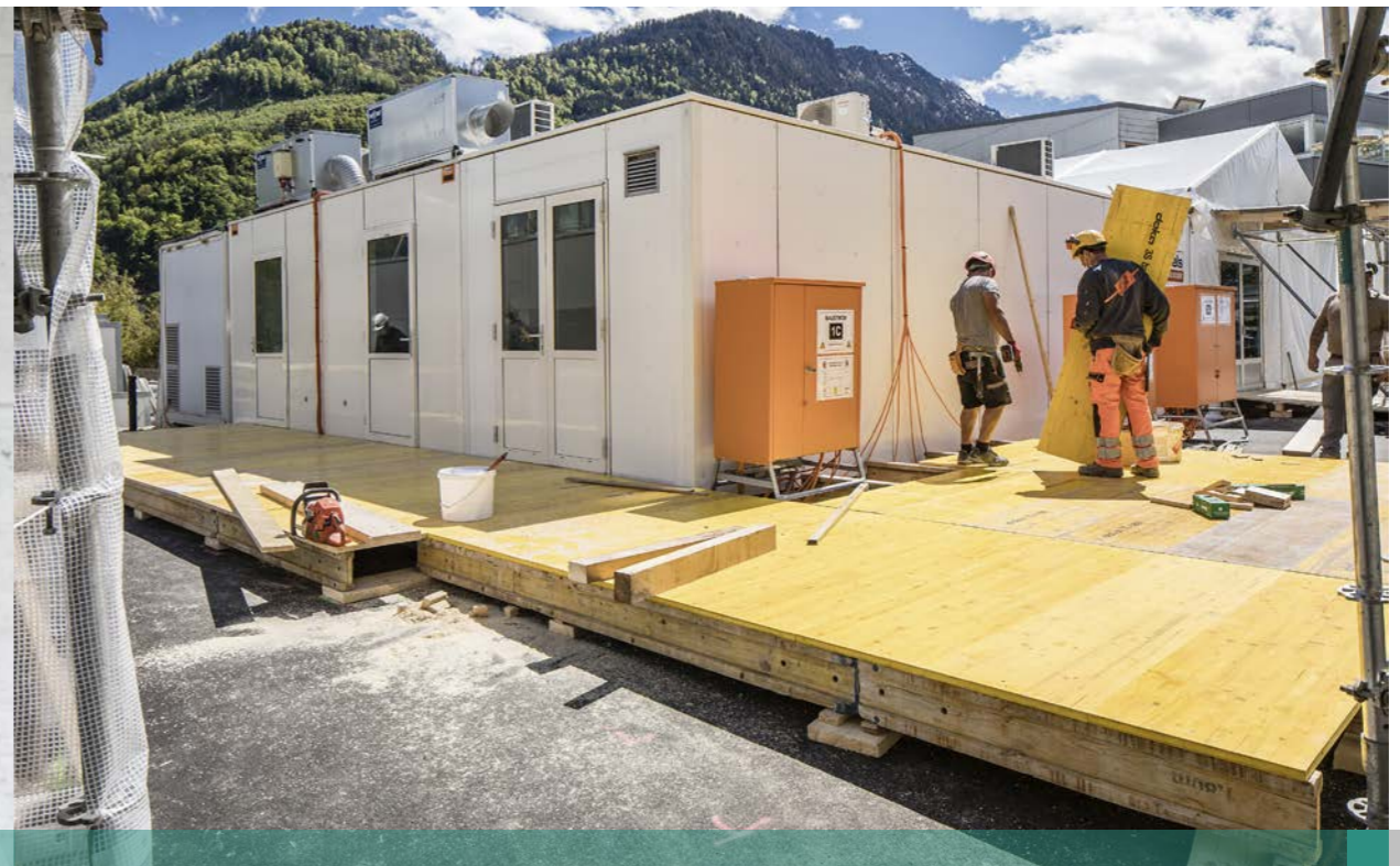
Aufgrund der Bauarbeiten auf dem Campus Interlaken werden die Spitalküche sowie das Restaurant provisorisch auf die «grüne Wiese» in den Spitalgarten verlegt.
